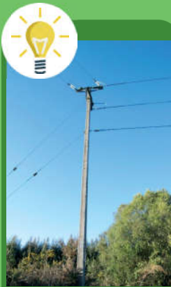
Poste de línea eléctrica (de distribución) de 23 kV.
